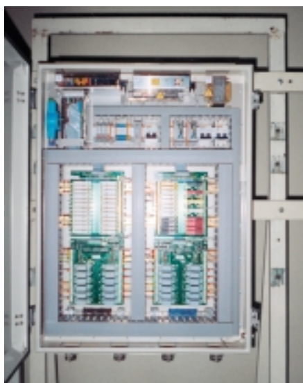
Рис. 5. Аппаратура системы пожаротушения
